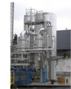
Évaporateur à Recompression Mécanique de Vapeur
